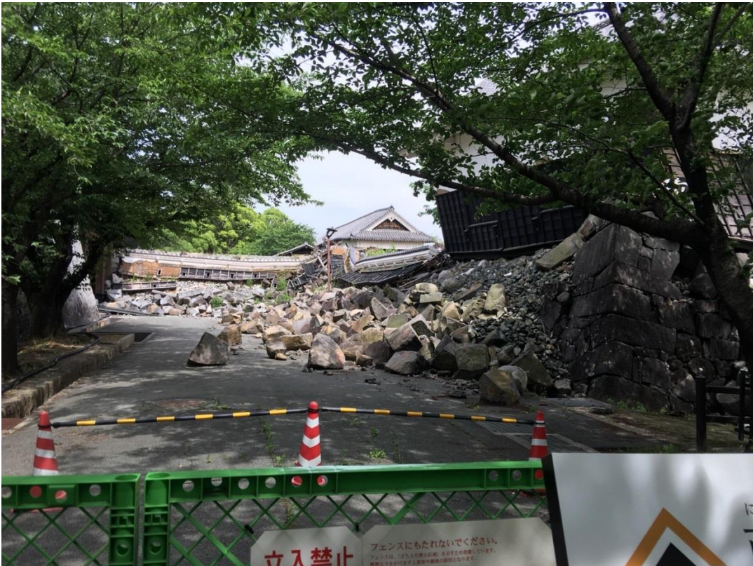
熊本城の被災現場視察
