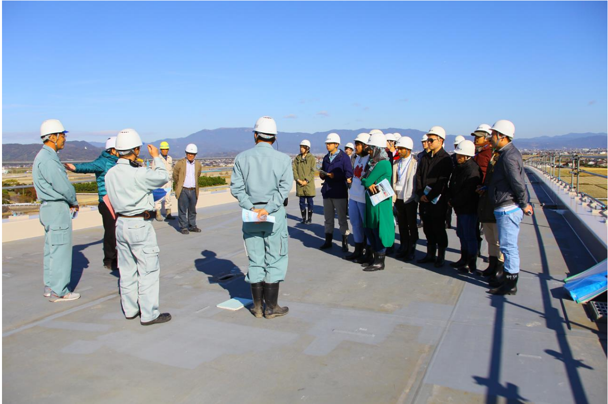
有明海沿岸道路（佐賀福富道路）・六角川大橋建設現場の視察
